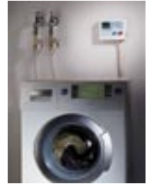
Hot fill aansluiting op een wasmachine.
